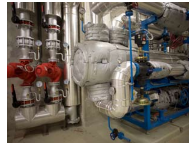
Heißwasser wird über den WÄRMTAUSCHER ins Fernwärme-Netz eingespeist Hot water is fed into the district-heating network via HEAT EXCHANGER
