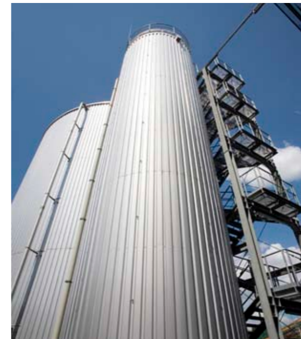
Der SUSPENSIONSSPEICHER hat ein Nutzvolumen von 200 m 3 The SUSPENSION RESERVOIR has a usable volume of 200 m 3
