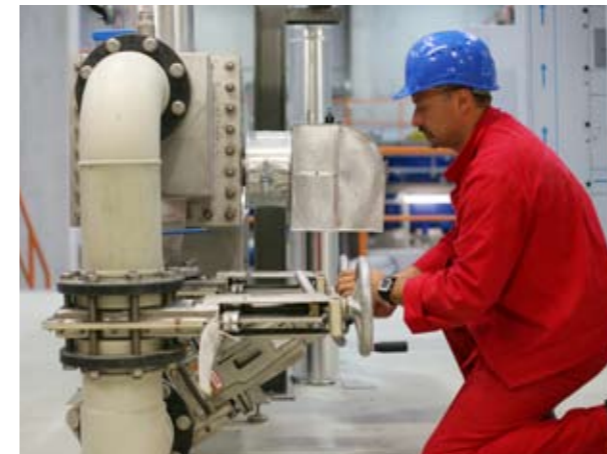
VERTEILUNG DER SUSPENSION in die Hygienisierungsbehälter The ALLOCATION OF THE SUSPENSION into the hygienisation containers
