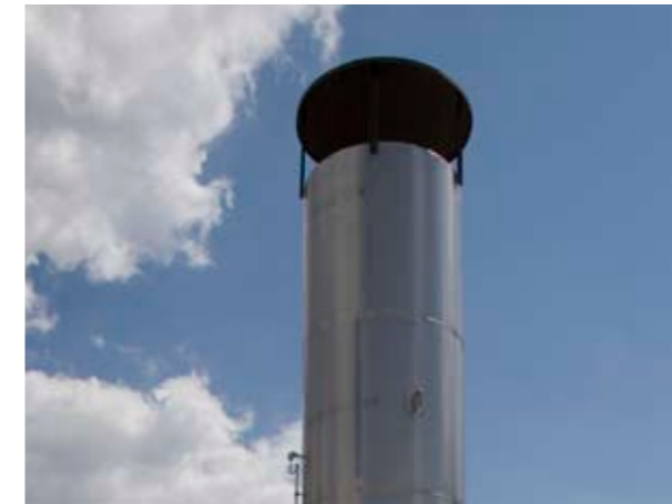
Über die SICHERHEITSFACKEL kann im Notfall das Biogas gefahrlos verbrannt werden Via SECURITY TORCH, the biogas can be burned safely in a case of emergency
